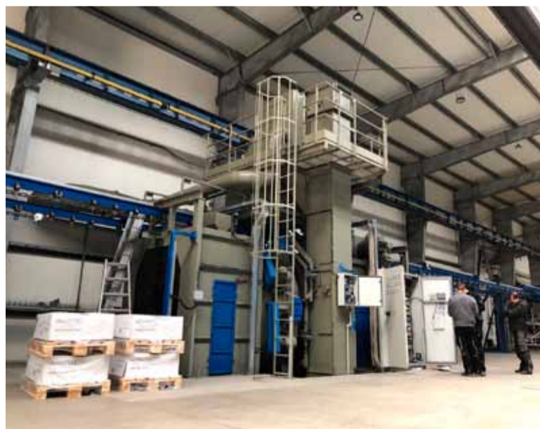
Obr. 2: Plně mechanizovaný tryskací box
